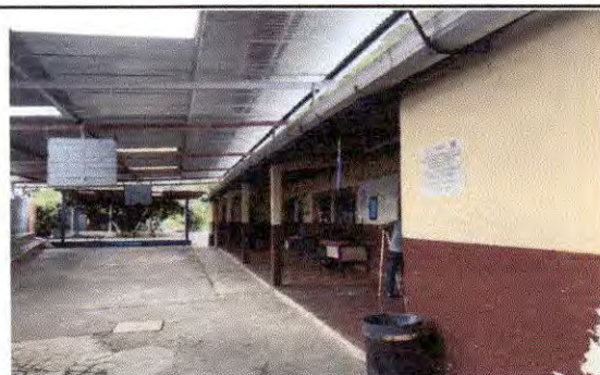
Foto 3: Estructura para techo en malas condiciones.
