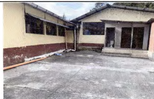
Foto 4: Patio trasero de escuela sin techo.
